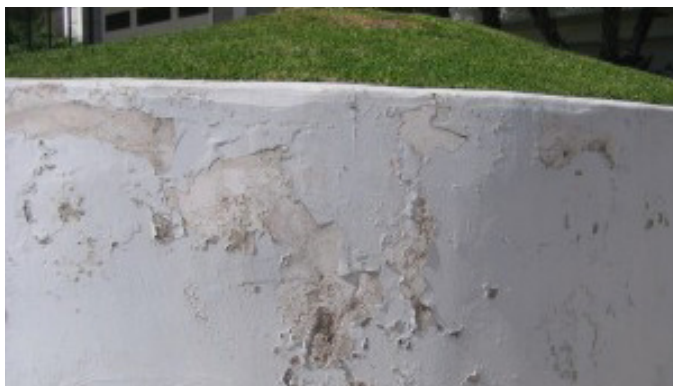
Figura 3: Daño por agua en la pared de estuco.
