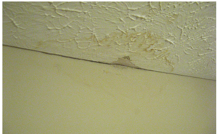
Figura 2: Revestimiento arrugado debido al daño del agua.
