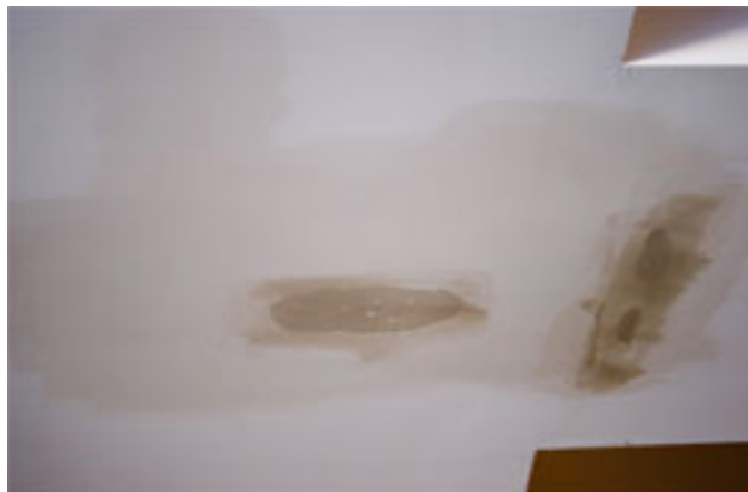
Figura 1: Pared de tabla de yeso manchado con agua.
