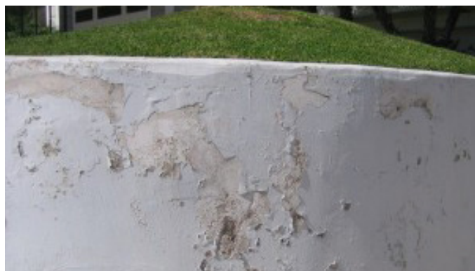
图 3: 灰泥墙壁上的水破坏。
