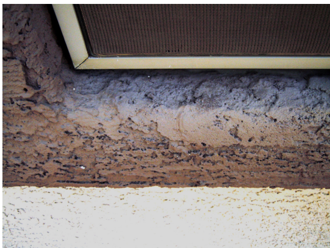
Figura 1: Degradación prematura de pintura del color oscuro en superficies horizontales.
